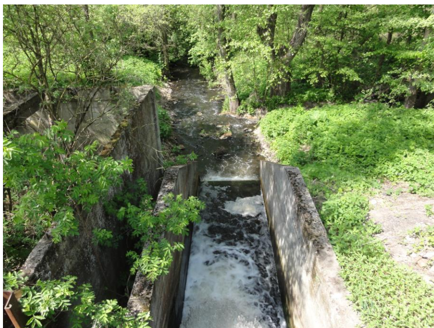
Fot. 15. Urządzenia piętrzące na rzece Lubieńce we wsi Klóbka
